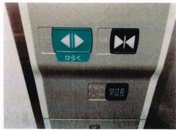
4号館エレベーター点字
